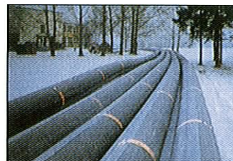
Dricksvattenintag från 170 meters djup i sjön Mjösa, Norge, 1990, storlek 900 mm, längd 3500 m.
